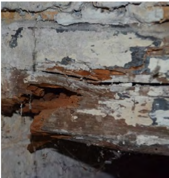
Balkenkopf mit massivem Fäulnissschaden – Der Fachbetrieb muss auch den Unterbau prüfen
