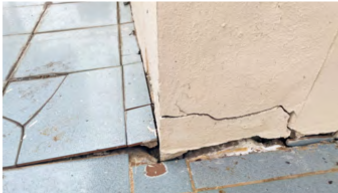
Balkonabdichtungen sollten genau überprüft werden
