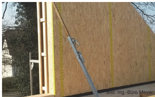
Abb. 74: Alles richtig gemacht: Raumhohe hochwertige OSB-Platten auf der Raumseite ohne unnötige Dampfsperren.
