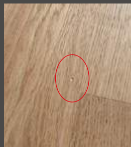
Boden mit Beschädigung
